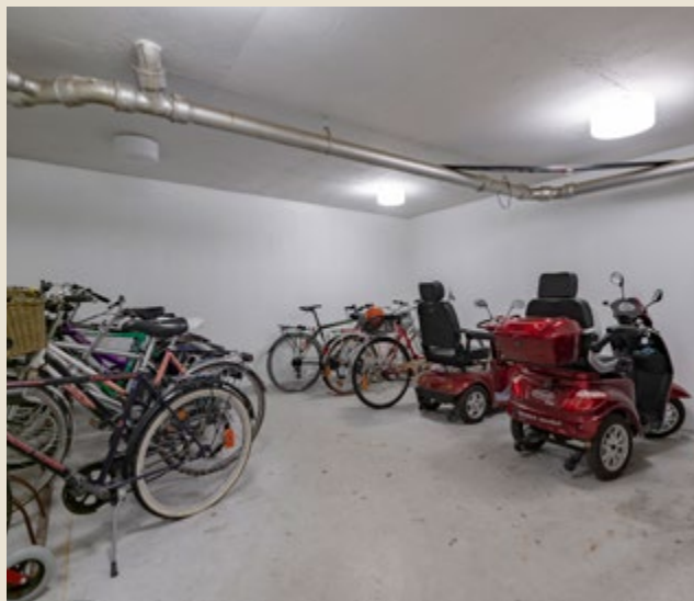
Pyörävarastossa on latauspistokkeita sähkökäyttöisille kulkuvälineille.
